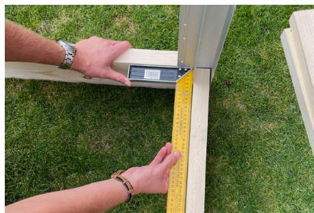
4. Toto opakujte pro všechny 4 rohy a sestavte první řadu záhonu. Kolmost rohů ověřte úhelníkem.
